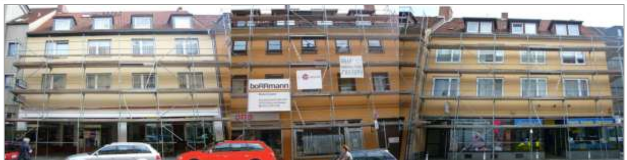
Sonnenstraße: Ursprüngliche Situation, Visualisierung der Stadt und eingerüstete Fassaden mit abgestimmten Fassadenanstrichen (von oben nach unten)
