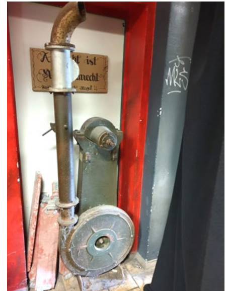
Nach diesem Gegenstand hatten wir gefragt: Es handelt sich um einen Schutzraumlüfter. Zur Be- und Entlüftung des Raumes wurde eine Handkurbel benötigt.
