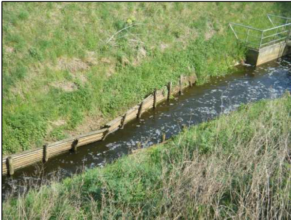
Abbildung 2: abgängiger Verbau oberhalb Entnahmepumpwerk
