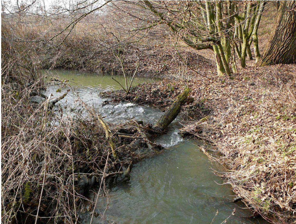
Abbildung 9: Überlauf des Rückhaltebeckens an der Westseite
